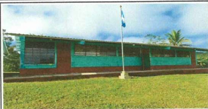
Foto1: PINTURA EN MURO EXTERIOR DETERIORADO, REQUIERE CAMBIO DE COLOR
